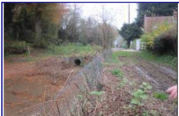
Encombrement important suite à de fortes précipitations (novembre-2012)
