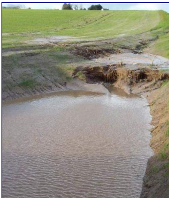
Encombrement de la mare tampon Epincelles suite aux pluies hivernales (2015)
